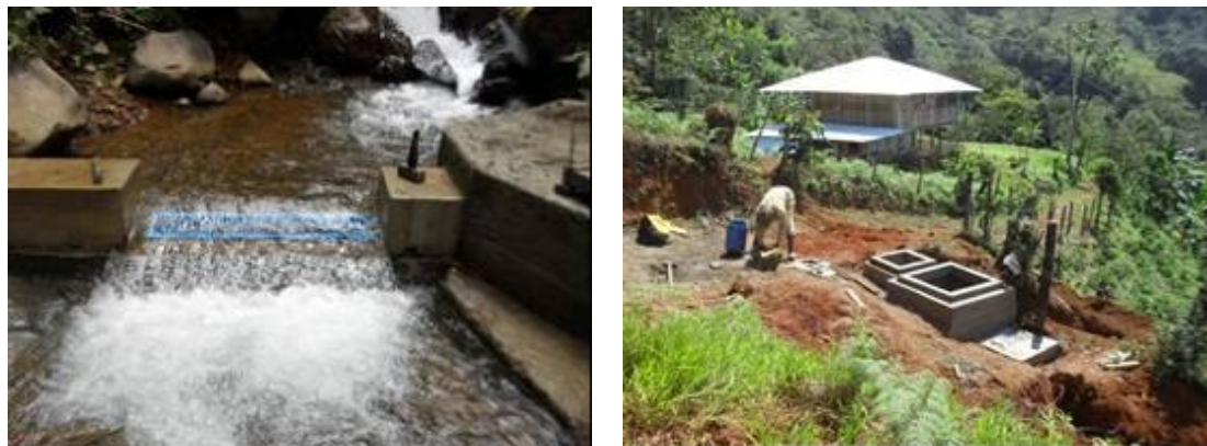
Bocatoma en funcionamiento tubería galvanizada aducción y desarenador
