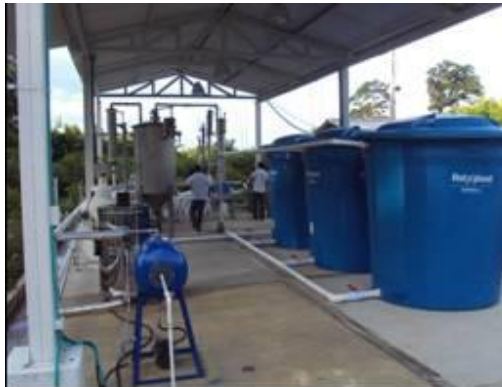
Planta de tratamiento de aguas mieles en Caicedonia
