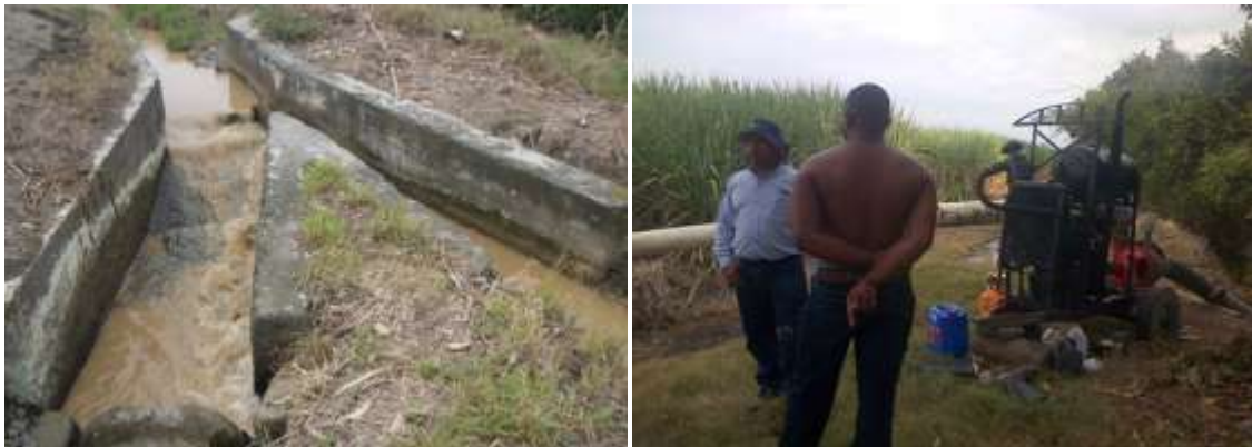
Foto 27 y 28. Seguimiento al manejo de aguas superficiales y control de aguas subterráneas
