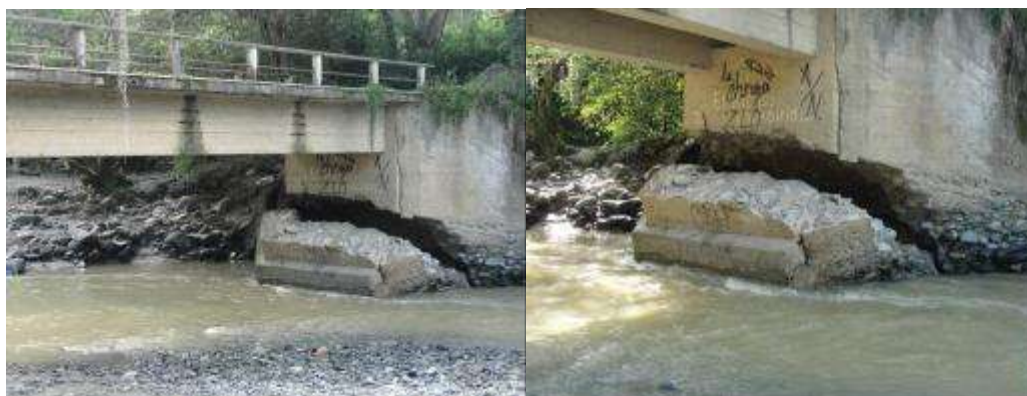
Afectación por ola invernal en el Rio Guadalajara
