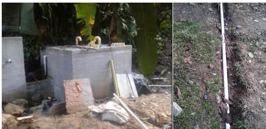
TANQUE DE ALMACENAMIENTO AIZAMA Y LÍNEA DE CONDUCCIÓN PRINCIPAL NASA KIWE
