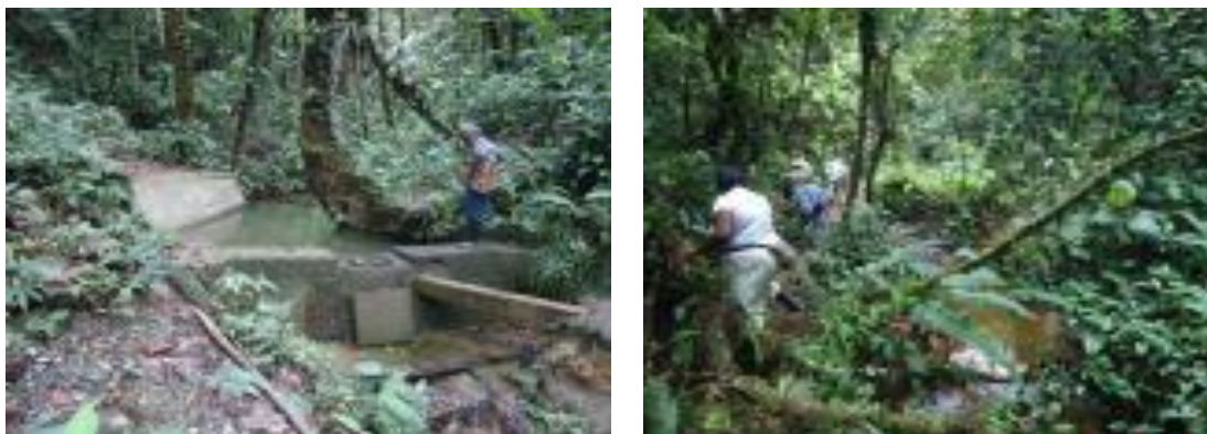
Foto 43. Bocatoma de acueductos regionales
