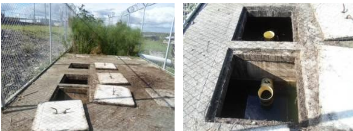
Foto 50. Sistema de tratamiento construidos y operando eficientemente TL-BUEN
