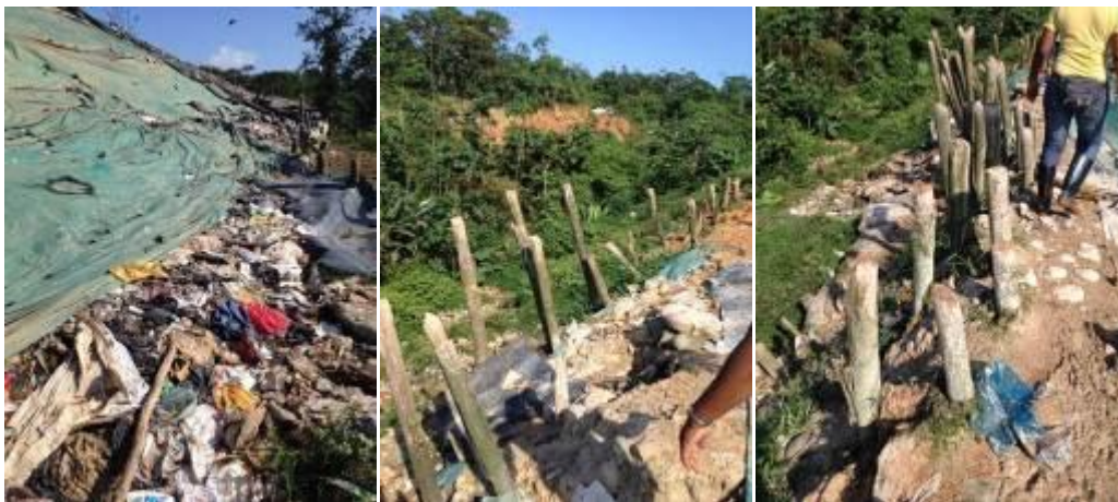
Foto 47. Obras constructivas realizadas por el distrito que presentan riesgo de estabilidad del domo del área de contingencia.
