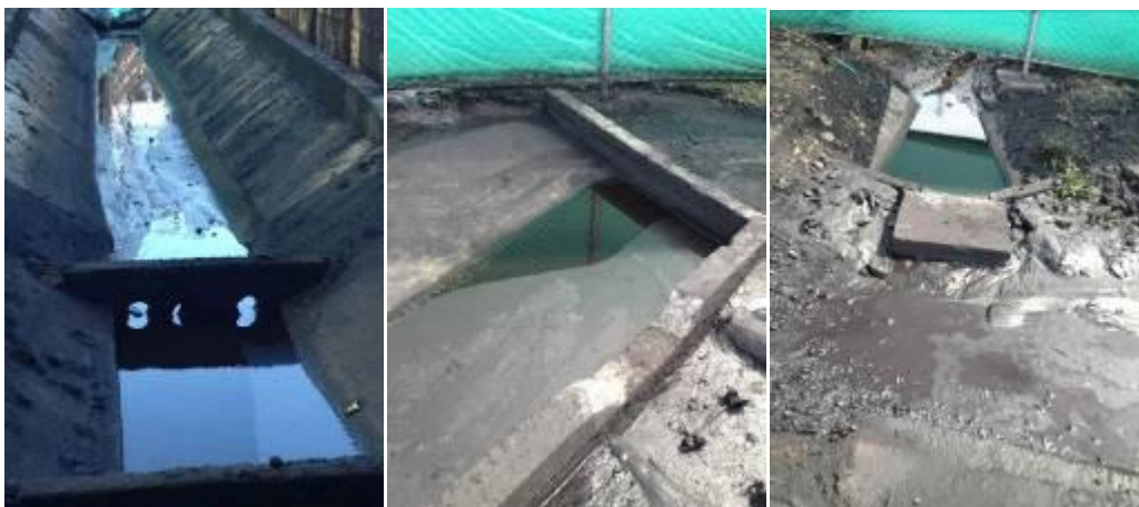
Foto 53. Canales perimetrales y sedimentadores
