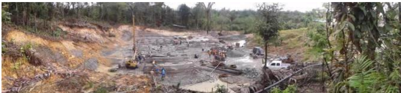
Panorámica General de la Construcción de la PTAR Macroproyecto de Vivienda de Interés Nacional San Antonio
