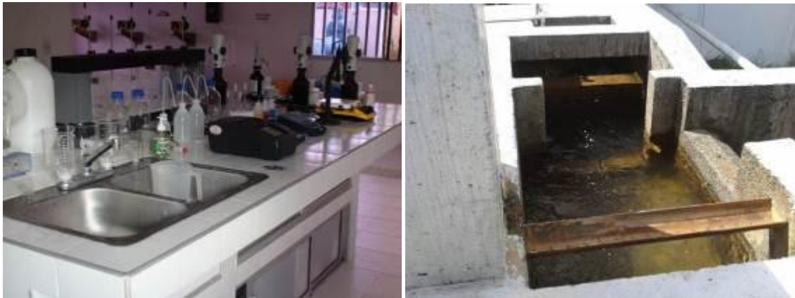
Foto 12. Laboratorio de aguas y estructura de recibo de aguas del sistema de bombeo de la base Naval Bahía Málaga
