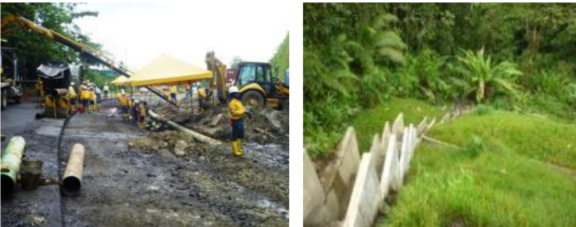
Foto 40. Derrame de ACPM en la vía Cabal Pombo
