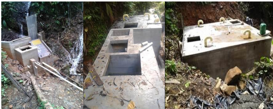
BOCATOMA - DESARENADOR NASA KIWE Y TANQUE DE ALMACENAMIENTO
