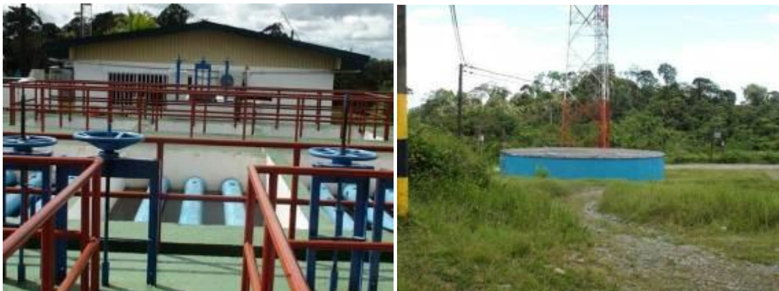
Foto 11. Tecnología de potabilización convencional y tanque de almacenamiento
