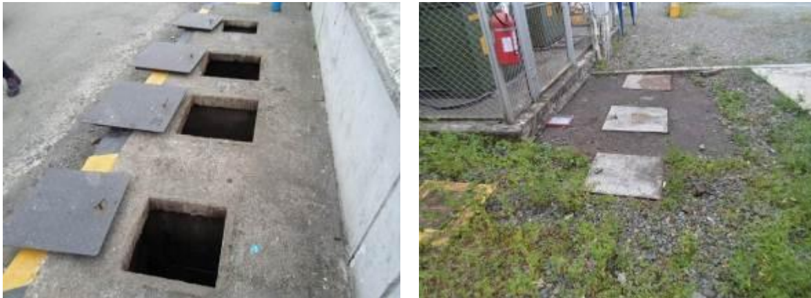
Foto 51. Trampa de grasas y tanque séptico estación de Servicio Terpel Buenaventura
