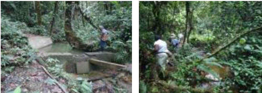
Foto 43. Bocatoma de acueductos regionales
