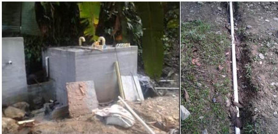
TANQUE DE ALMACENAMIENTO AIZAMA Y LÍNEA DE CONDUCCIÓN PRINCIPAL NASA KIWE
