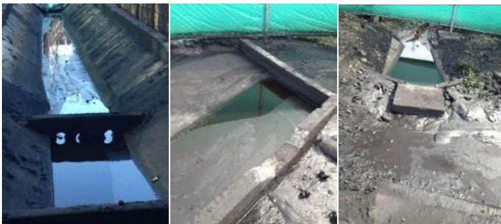
Foto 53. Canales perimetrales y sedimentadores
