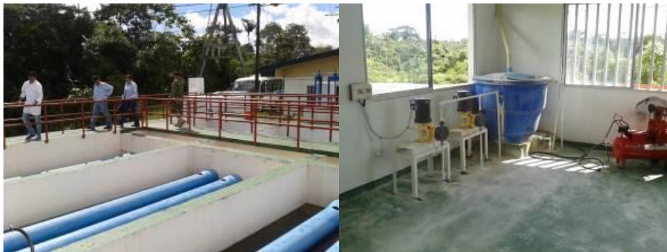
Planta de tratamiento acueducto Base Naval – Bahía Málaga
