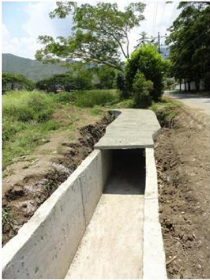
Seguimiento y monitoreo obras Canal recolector aguas lluvias alto el Cangrejo Municipio de Vijes
