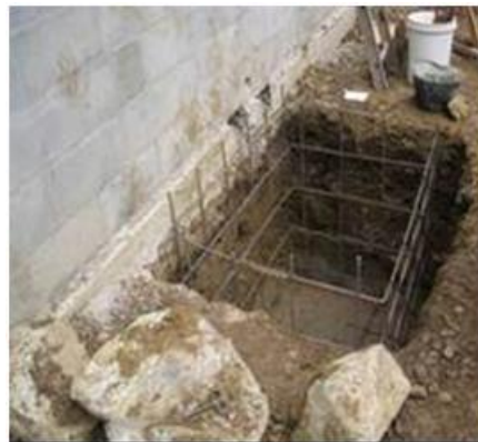
Tanque de recepción de lixiviados de la compostera
