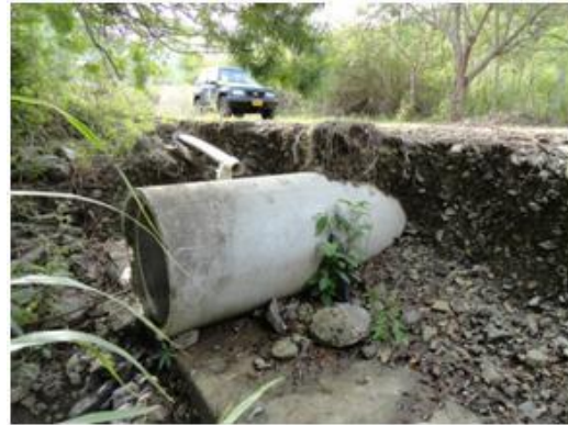
Carreteable que conduce Montañitas Vereda Mulaló, movimiento en masa, afectó la banca de la vía.
