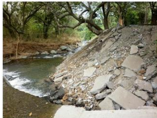
Rio Arroyohondo municipio de Yumbo. Seguimiento a intervención de cauces por particulares
