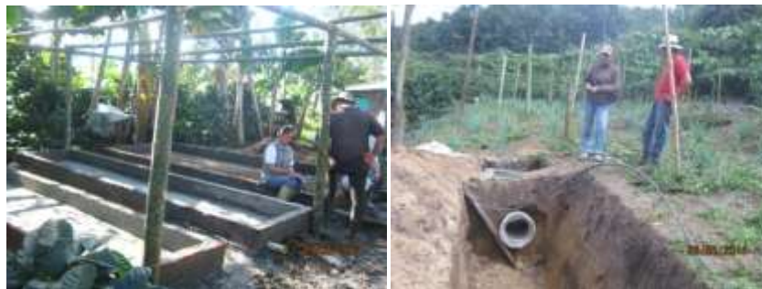
Avances en la construcción de fosa y lombricultivo en El predio La Esperanza en Cerro Azul
