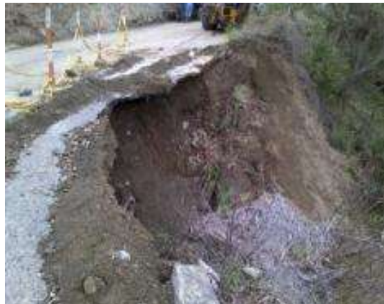
Estado de la vía a Primavera que genera riesgo sobre la infraestructura del SARA BRUT
