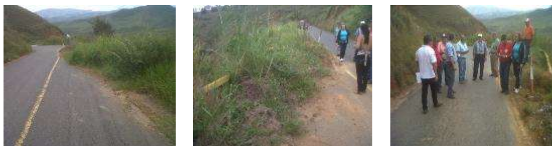
Recorrido de monitoreo identificación de situaciones de riesgo de la vía El Dovio- Roldanillo Se detectaron 17 situaciones puntuales importantes, que amenaza la estabilidad de la banca de la vía El Dovio- Roldanillo
