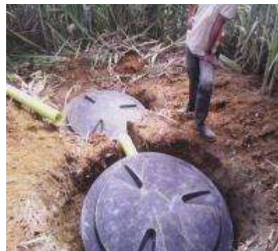
Tanque séptico y filtro
