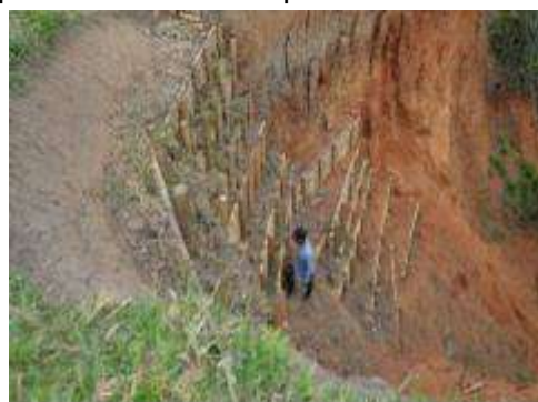
Área intervenida afecta por el movimiento en masa Quebrada la Italia, Predio La Italia
