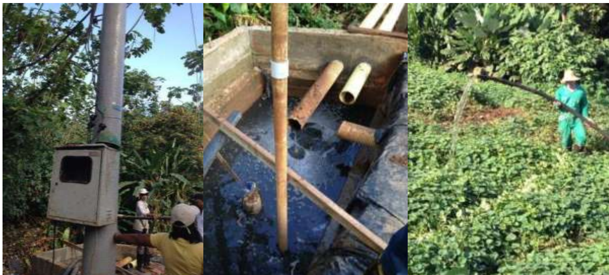
SISTEMA ELECTRICO BOMBEO
