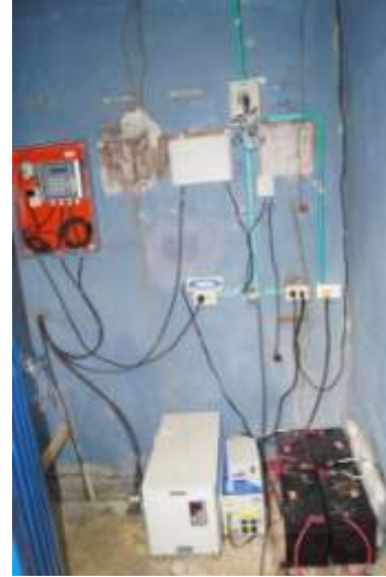
Estado de abandono de los macromedidores a la salida planta de tratamiento
