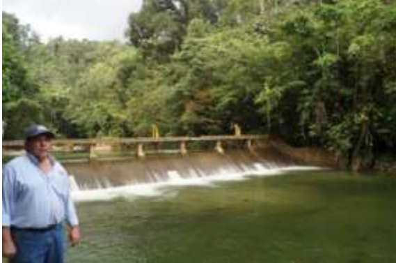
Bocatoma principal del acueducto de Buenaventura, sobre el Rio Escalerete
