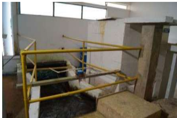
Macromedidor electrónico de caudal sobre canaleta parshall
