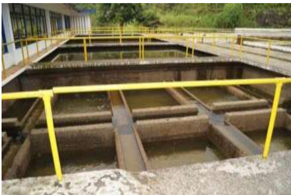
Baterías de filtrado Planta Escalerete
