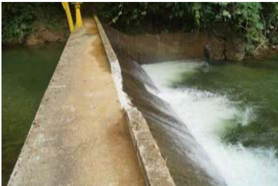
Debilitamiento del puente de operación de la compuerta de fondo sobre el dique de la bocatoma
