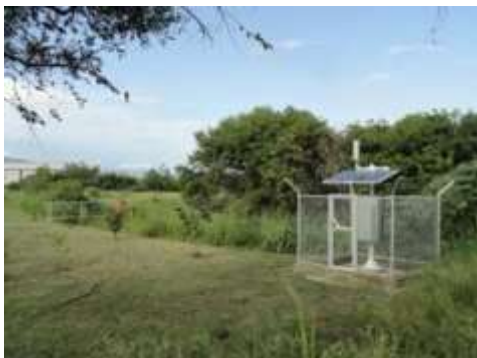
Estación hidrométrica y de calidad de agua Cali – El Cortijo
