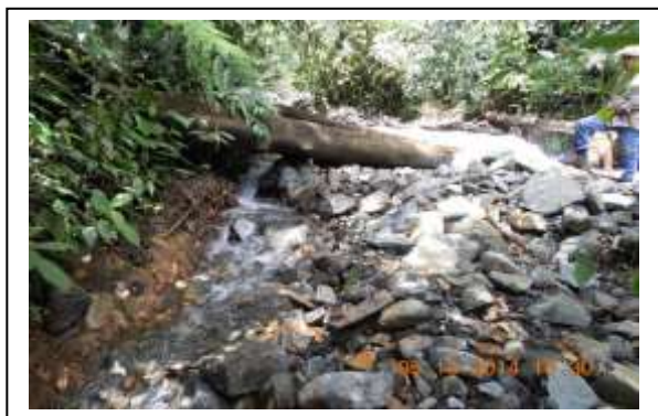
Troncos y piedras que destruyeron la bocatoma del lago de El Topacio, sobre la quebrada Los Indios.
