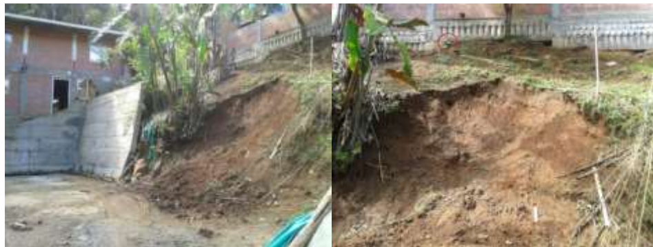
En la Vereda Nieves Bajas, Corregimiento El Saladito, Municipio de Santiago de Cali, se monitorearon escenarios de deslizamientos y erosión en los taludes del predio Villa Garpel y la propiedad del Señor Carlos Arturo García.
