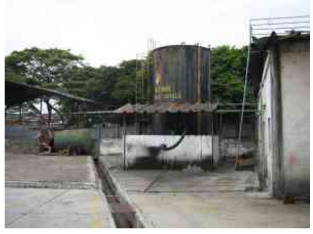
Tanque de almacenamiento de ACPM
