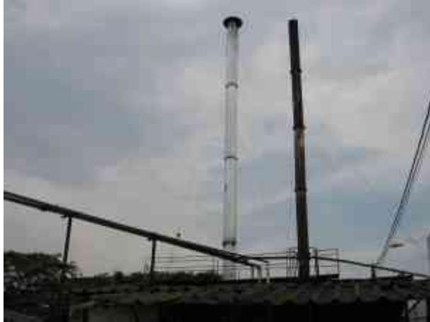
Chimeneas y plataforma
