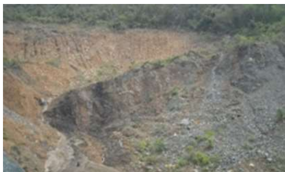
Foto 428. Estado Cárcava Los Aguacates. Corregimiento Monteloro, Tuluá
