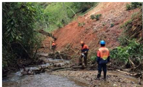
Foto 429. Troce de material vegetal - Quebrada La Quisquina
