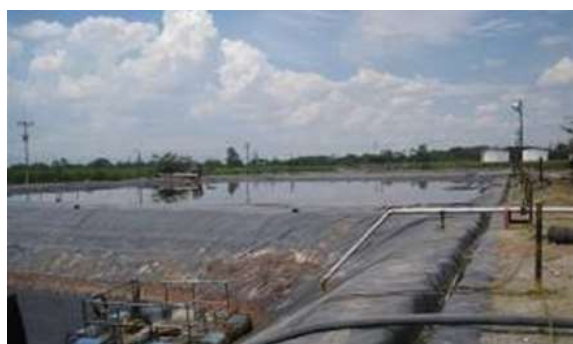
Foto 384. Lagunas de almacenamiento de vinaza - Destiladora Ingenio Mayagüez
