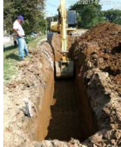
Foto 440. Construcción de trincheras : k12+775 al k14+125 sector I - Brisas de nuevo amanecer
