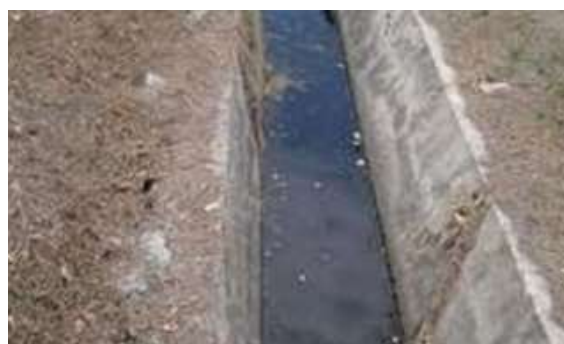
Foto 385. Canales – Aguas de lavado compostaje – Destiladora Ingenio Mayagüez
