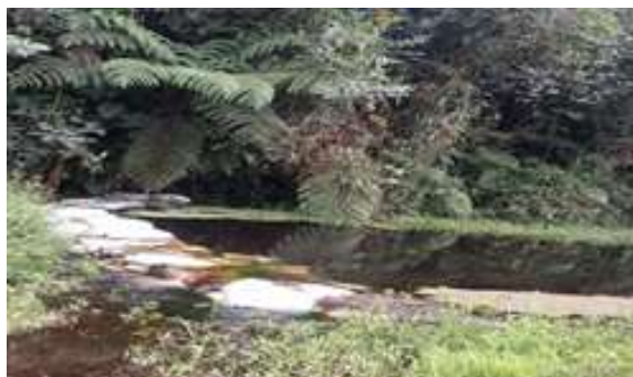
Foto 261. Intervención espejo lagunar a través del establecimiento de una estructura pantalla con costales de polipropileno (Tipo bolsacreto).
