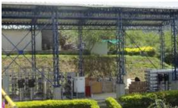
Foto 377. PTL – Tecnología Osmosis Inversa Relleno Sanitario Colomba – El Guabal
