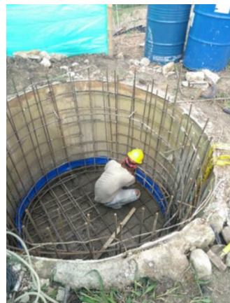
Foto 213. construcción de tanque de 5 m 3 del sistema de reservorios cerro de Cristo Rey.
