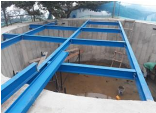
Foto 212. Construcción de tanque principal del sistema de reservorios cerro de Cristo Rey.
