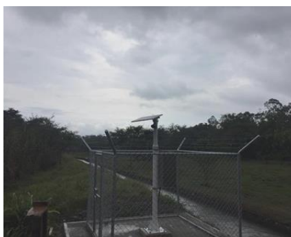
Foto 122. Caseta con el panel solar y gabinete, estación hidrométrica Amaime-Der 2.
