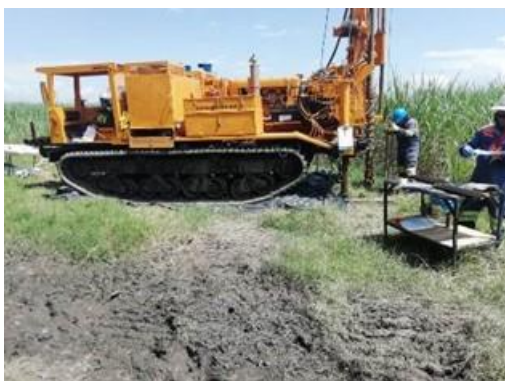
Foto 59. Protección superficial de pozos-Cuenca Guadalajara-Buga.
