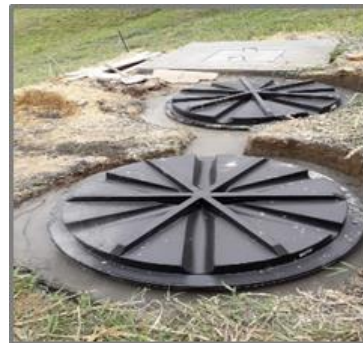
Foto 106. Tanque séptico, filtro anaerobio y pozo de absorción construido municipio de Alcalá. DAR Norte.
