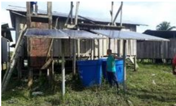
Foto 153. Sistema Fotovoltaico unifamiliar instalado en la comunidad indígena de Puerto Pizarro, Distrito de Buenaventura.
