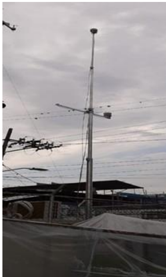
Foto 201 Equipo que hace parte del Sistema de Calidad del Aire ubicada en Yumbo
