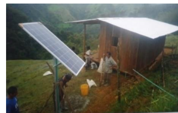
Foto 6. implementación de sistemas fotovoltaicos, Alto Hermoso El Dovia
