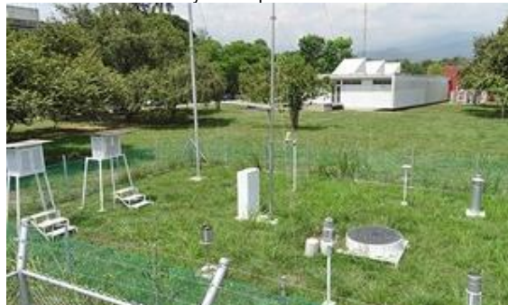
Foto 268 Equipos entregados e instalados
