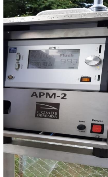
Foto 193 Equipos instalados en la ciudad Palmira
