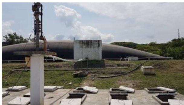
Foto 95 Sistema de tratamiento de aguas residuales empresa Colombiana, corregimiento La Paila, municipio de Zarzal – Permiso de Vertimientos Líquidos – DAR BRUT
