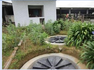
Foto 20. Batería sanitaria, tanque séptico y filtro anaerobio. Sistema de Tratamiento de Aguas Residuales para la comunidad indígena de Mateguadua en el municipio de Florida.
