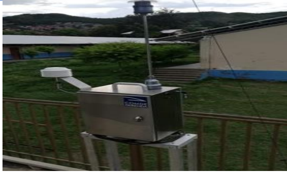
Foto 260 Equipo que hace parte del Sistema de Calidad del Aire de Cali
