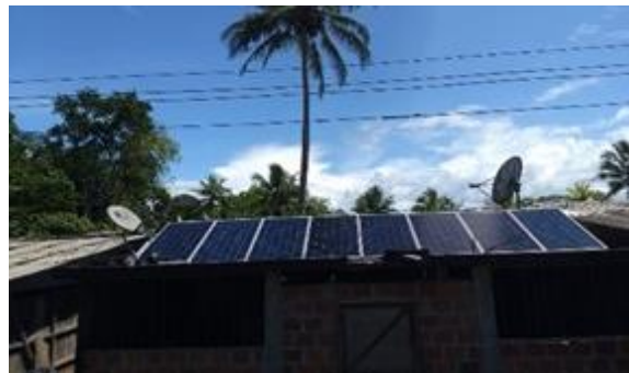
Foto 154. Sistema Fotovoltaico instalado en escuela de una comunidad Del Consejo Comunitario de la Comunidad Negra de Mayorquín, Distrito de Buenaventura., Distrito de Buenaventura.
