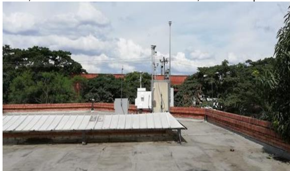
Foto 267 Equipos entregados e instalados
