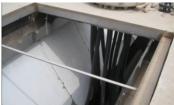
Foto 75 Accesorios de acero al carbón y soportes mangueras reactor UASB. Archivo CVC, 2016
