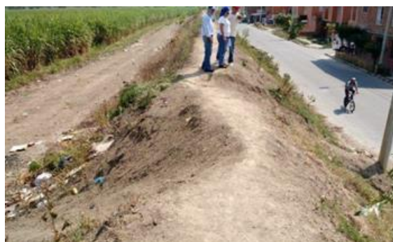
Foto 142. Visitas de verificación estado dique de protección contra inundaciones Ciudad del Campo. DAR Sur Oriente. Archivo CVC 2016
