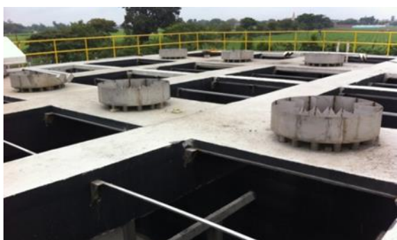
Foto 73. Cajas de distribución de caudales. Archivo CVC, 2016
