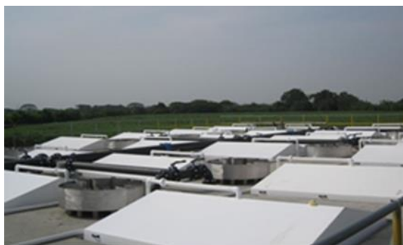
Foto 76 Reactor UASB con cubiertas instaladas. Archivo CVC, 2016
