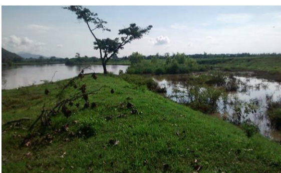
Foto 144. Amenaza por fallamientos diques Río Cauca, corregimiento San Antonio – Municipio Bugalagrande. Archivo CVC 2016
