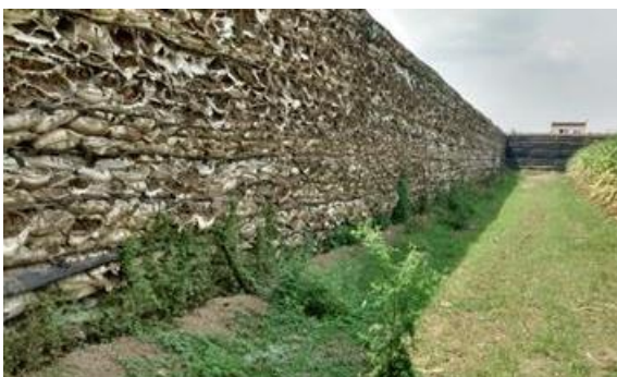
Foto 145. Estado dique de protección contra inundaciones Ciudad del Campo afectado por quema de caña. DAR Sur Oriente. Archivo CVC 2016
