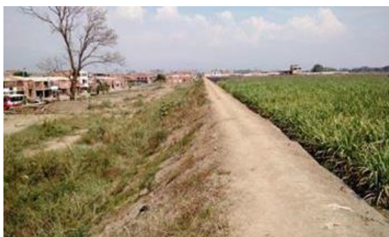
Foto 141. Visitas de verificación estado dique de protección contra inundaciones Ciudad del Campo. DAR Sur Oriente. Archivo CVC 2016.
