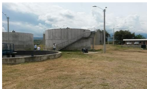
Foto 79. Sistema de tratamiento de aguas residuales del corregimiento de Sonso, Municipio de Guacarí. Archivo CVC, 2016
