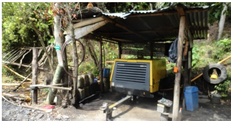
Foto 12 . Compresor tanques de combustible y caneca de residuos sólidos.
