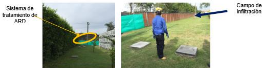
Imagen 1. Componentes del sistema de tratamiento de ARD de AkzoNobel Pulp and Performance Chemicals S.A.S
