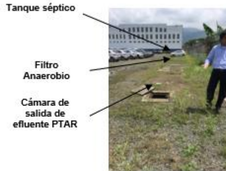
Imagen 1. Sistemas de Tratamiento de Aguas Residuales Domóticas de Autosuperior Ltda
