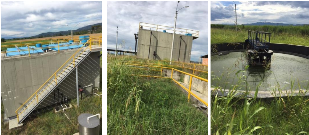
Fotografías 5,6 y 7. Estructuras sin usar debido a que no entra el agua residual para su tratamiento.
