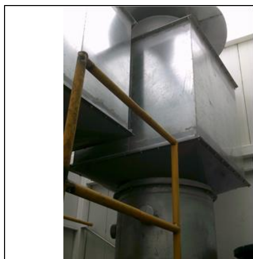
Fuente No 5 Filtro Molino 2da limpia con adecuación para medición directa
