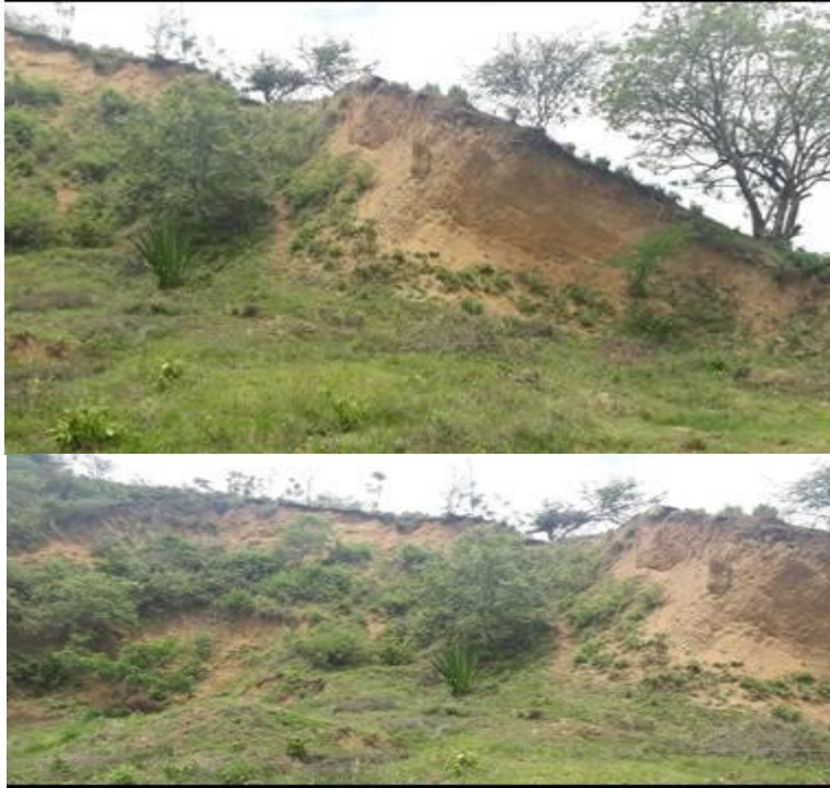
Imágenes 5-6-7. Taludes de la vía sin sistema de estabilización
