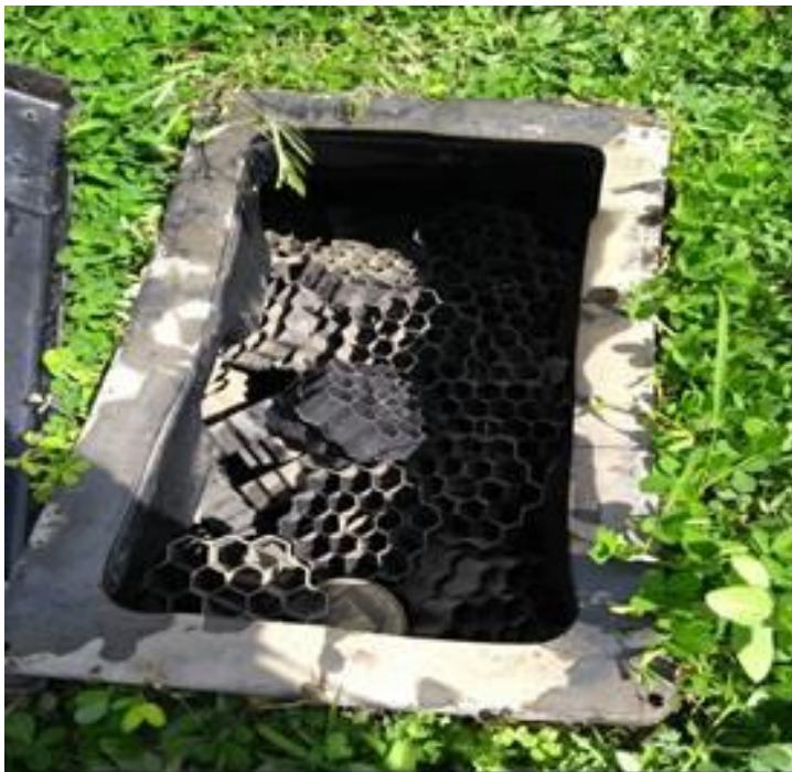
Foto 10. Tanque séptico. Con rosetas plásticas
