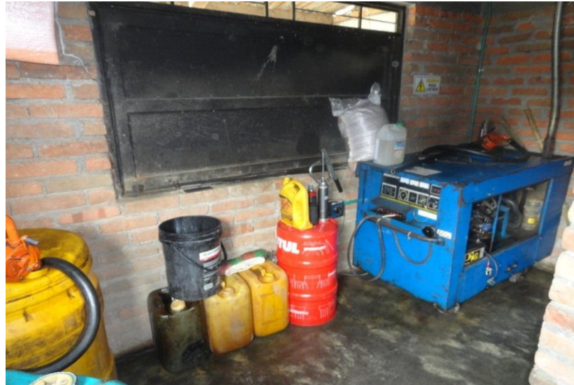
Foto No 8: bodega para almacenamiento de canecas vacías de combustible, y planta eléctrica
