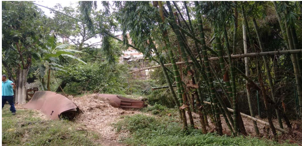
Foto No. 5. Relicto de guadua sobre la franja forestal protectora. Se recomienda no sembrar árboles de porte alto cerca al muro, para evitar su desestabilización.
