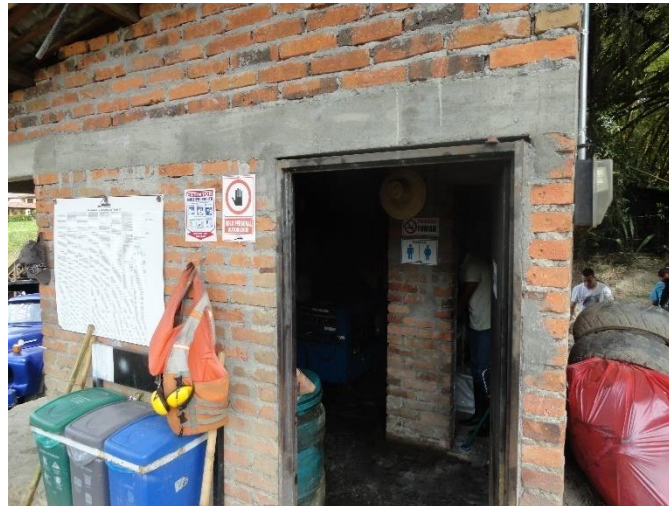
Foto 7: planta eléctrica y canecas para cargue de combustible a equipos
