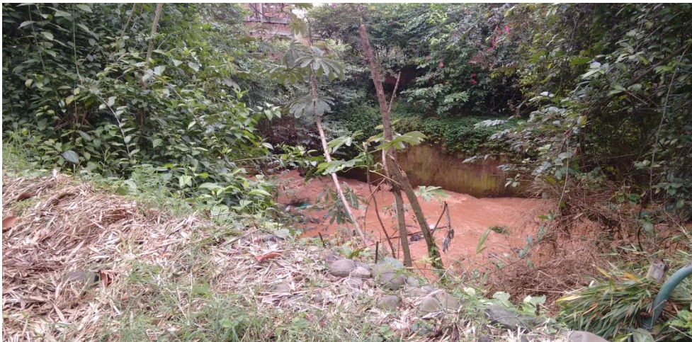
Foto No. 1. Se observa el muro en concreto construido sobre la margen derecha y el muro en gavión construido sobre la margen izquierda.
