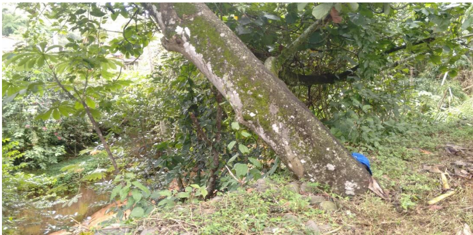
Foto No.3. Se observa la vegetación que se conservó sobre la cara superior del muro
