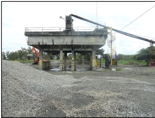
Foto No 11: Pila de material (gravilla) que se acumula cerca al tanque elevado.
