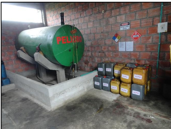
Foto 7: tanque de combustible de 1000 lt.
