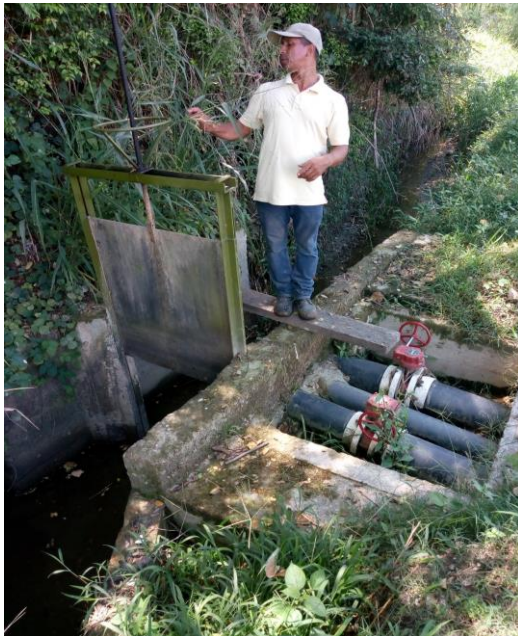
Captación lateral con compuerta
