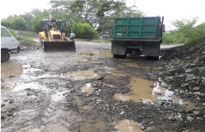
Fotos 2. Se observa la excavación mecanizada que supera la cota de fondo del cauce
