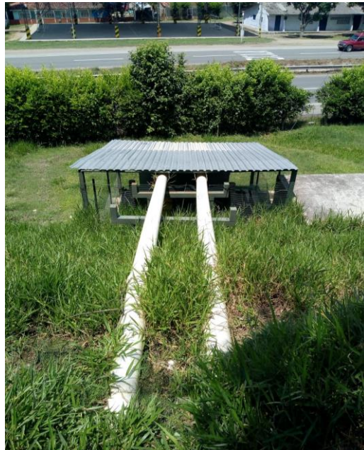
Tuberías para caudal motriz de las bombas
