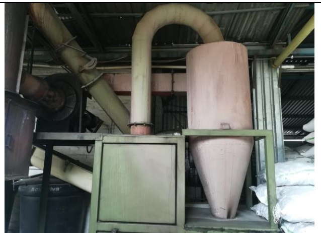
Sistema de control existente - Ciclón
