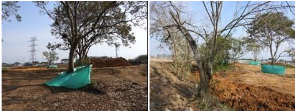
Imagen 3 y 4. Afectación de los árboles por la adecuación del terreno con equipos pesados
