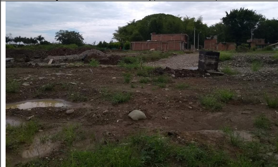
Figura 14 Predio con excavaciones y presencia de material pétreo.
