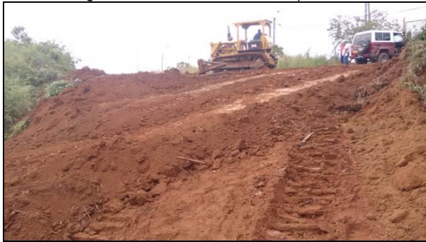
Fotos: Vista general de la intervención con apertura de la vía – Noviembre de 2016
