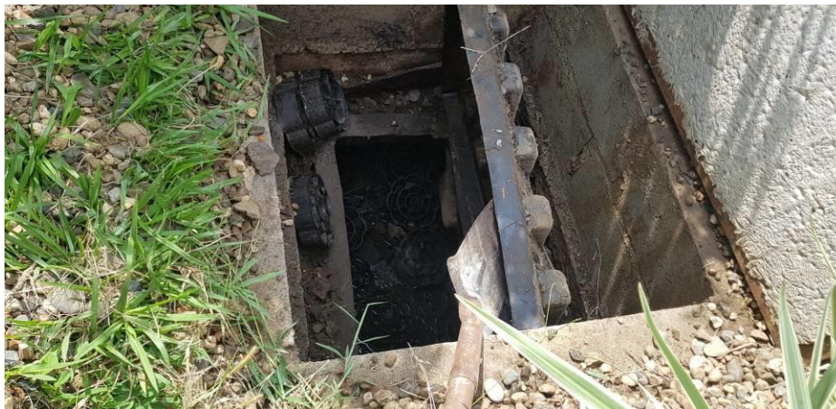
Foto 4. Filtro Anaerobio de Flujo Ascendente-FAFA prefabricado.
