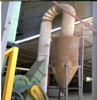
Foto 8. Decantador de humos, sistema cerrado de emisiones llegando a un decantador húmedo (No hay chimenea) viene de sistemas ciclones, filtro mangas
