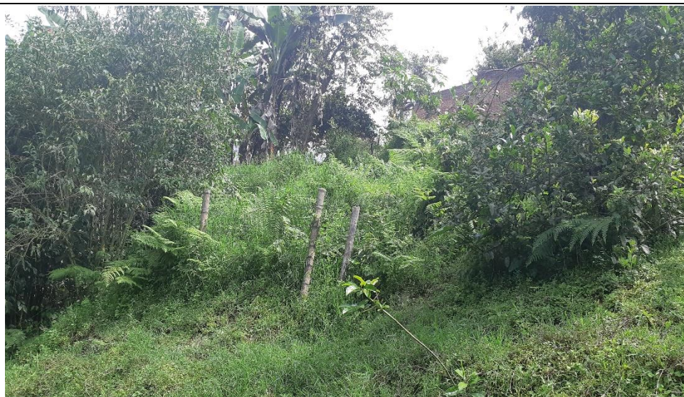
Foto 2. Se observa el estado actual del tanque que recibe los efluentes de la red de alcantarillado de la vereda Alaska, cubierto por rastrojo
