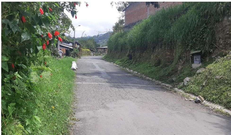
Foto 1. Se observa el estado de la última recámara de la red de alcantarillado de la vereda Alaska.
