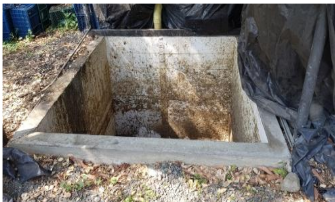
Imagen 2 Tanque de almacenamiento de grasas
