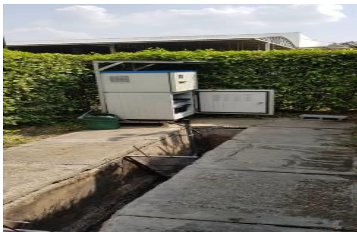
Imagen 1- Rejillas, sedimentador, trampa de grasas
