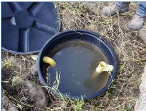
Foto 1. Trampa de Grasas (Prefabricado).
