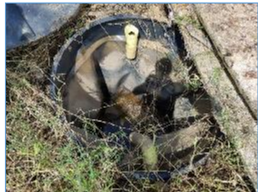
Foto 2. Estado del Tanque Séptico (Prefabricado)
