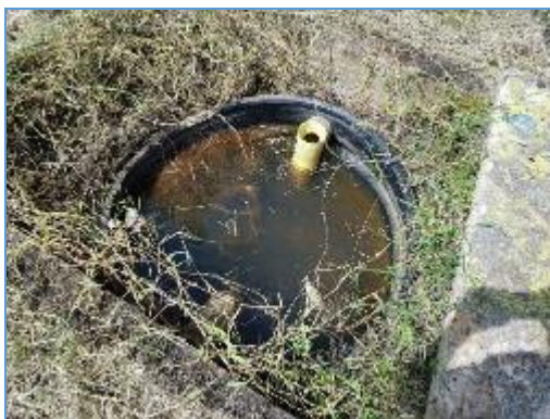
Foto 3. Filtro Anaerobio - FAFA
