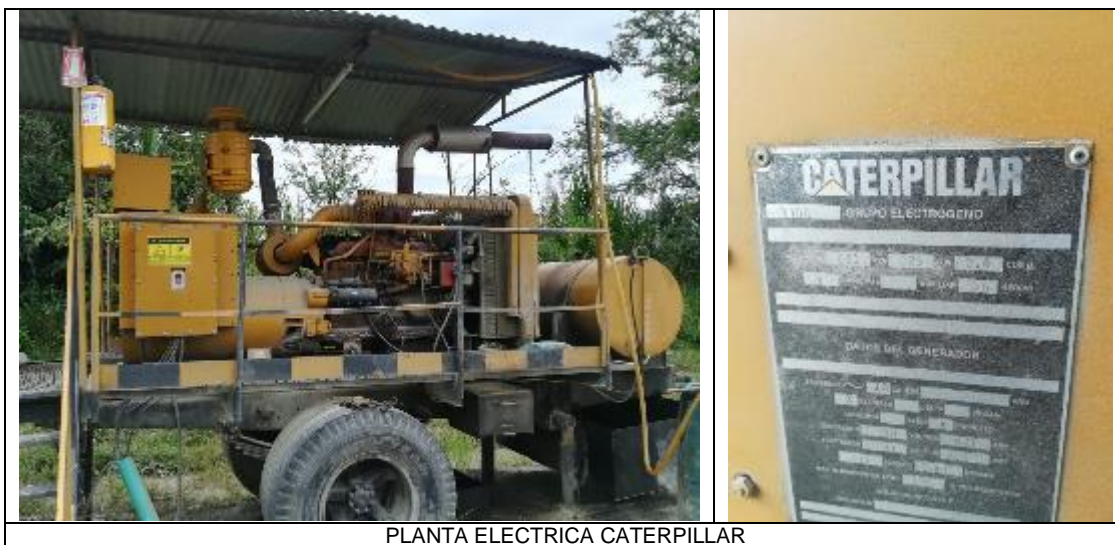
PLANTA ELECTRICA CATERPILLAR
