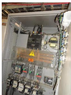
Foto No 6: transformador trifásico para control de energía a equipos.
