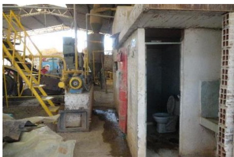
Foto No. 14. Unidad sanitaria y ducha área de proceso del ladrillo
