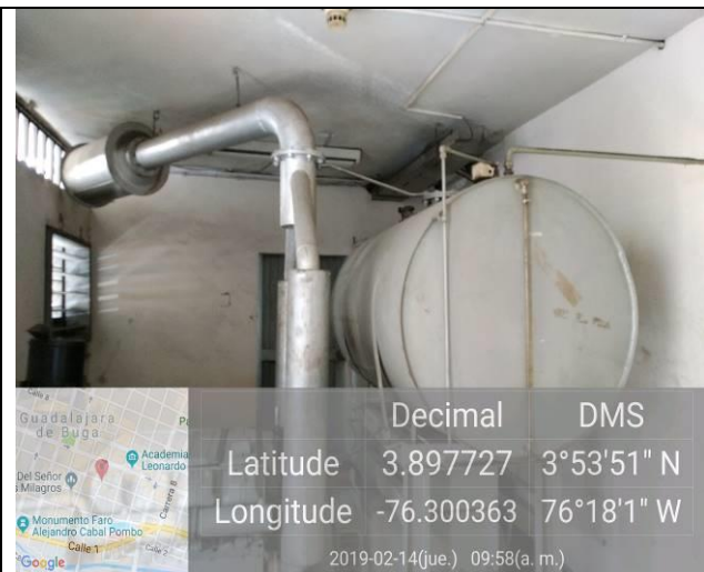
Foto No. 6: Salida de gases a torreta y almacenamiento de combustible.
