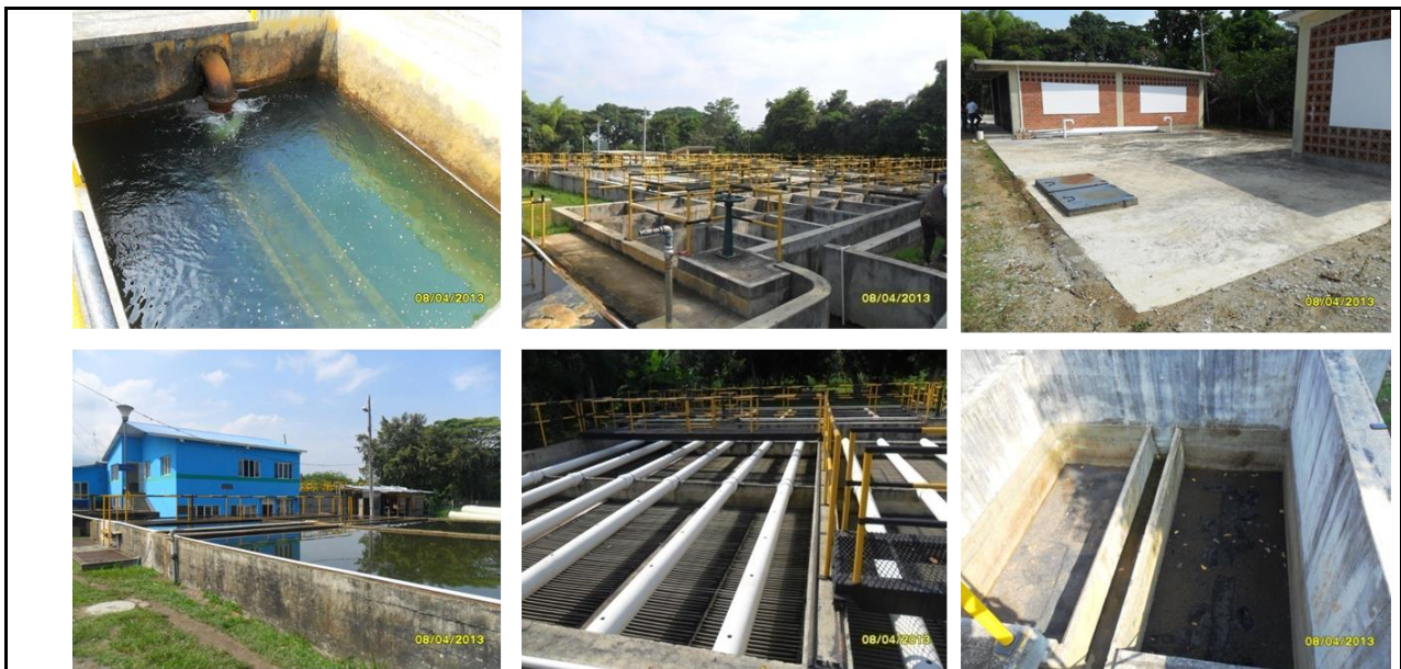
Foto 4. Filtros, sedimentadores, floculadores, mezcla rápida Fuente: fotos ACUAVALLE 2013.
