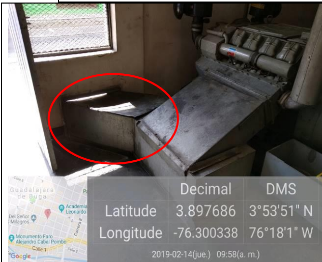
Foto No. 3: Salidas de evacuación del sistema de refrigeración del generador eléctrico.
