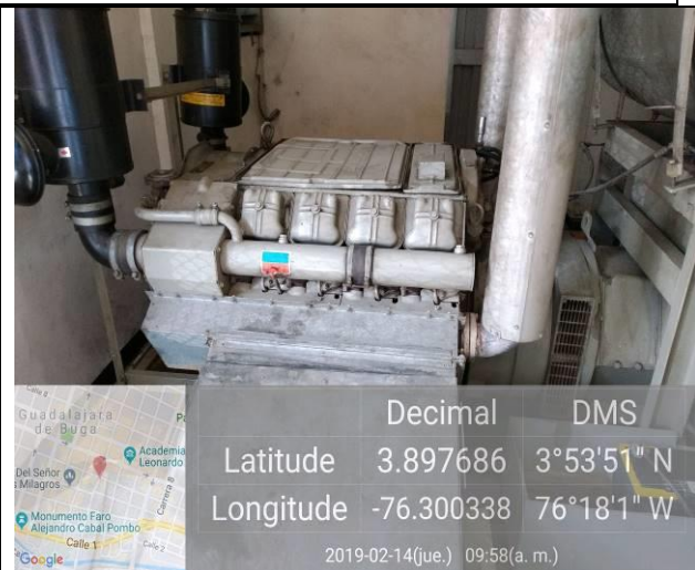
Foto No. 4: Motor del generador eléctrico.
