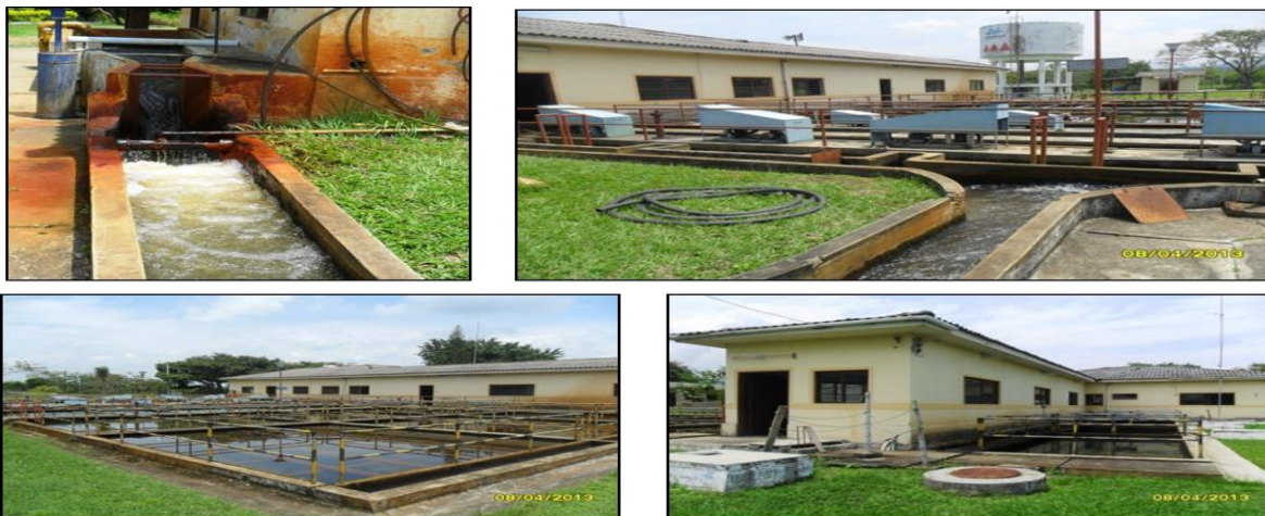
Foto 4. Canaleta de medición de caudal y mezcla rápida, floculadores, sedimentadores, filtración rápida, Fuente: fotos ACUAVALLE 2013.
