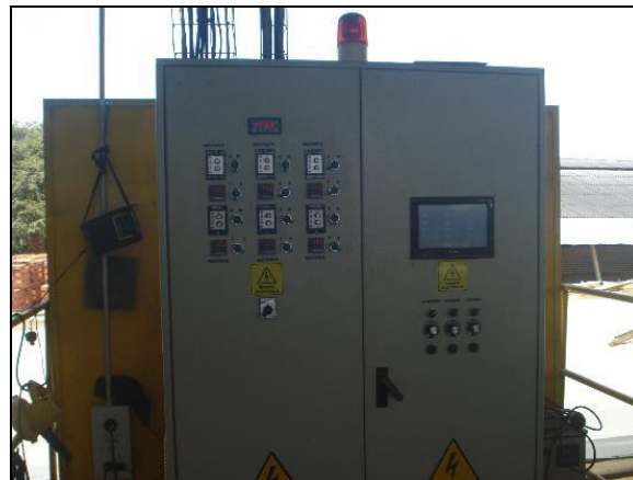
Foto No 11: Tablero digital de control de la planta de beneficio.
