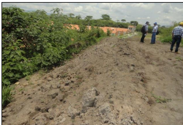
Foto No. 5. Material en los patios de acopio, que se ha deslizado en dirección a la malla que separa la planta con la urbanización.
