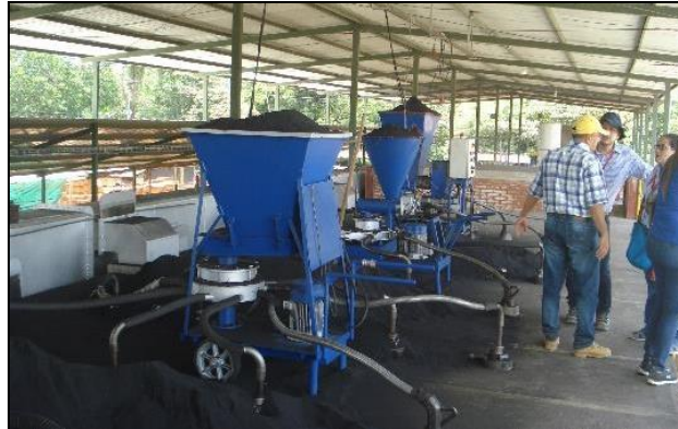
Foto No 10. Dosificadores de carbón térmico, para inyectar en el horno de quemado.
