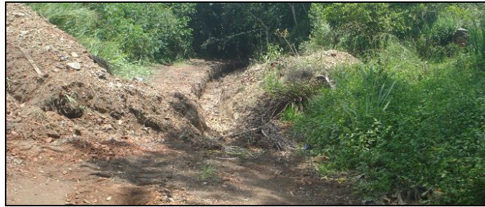
Foto No 12. Cuneta para el Manejo de aguas de escorrentía
