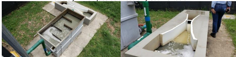
Fotos 5 y 6. Tanque contacto cloro y canaleta Parshall.
