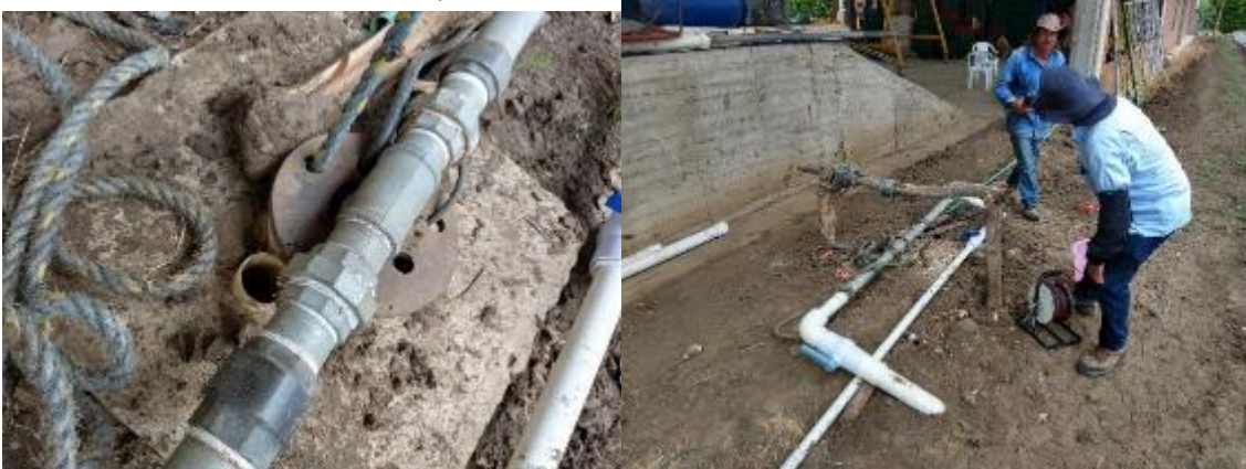
Foto 1 y Foto 2 Estado del pozo
