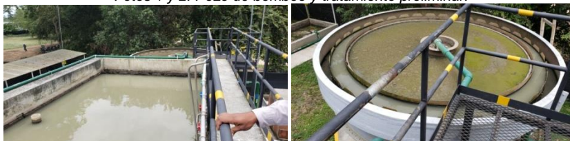
Fotos 3 y 4. Tanques de aireación y sedimentación.
