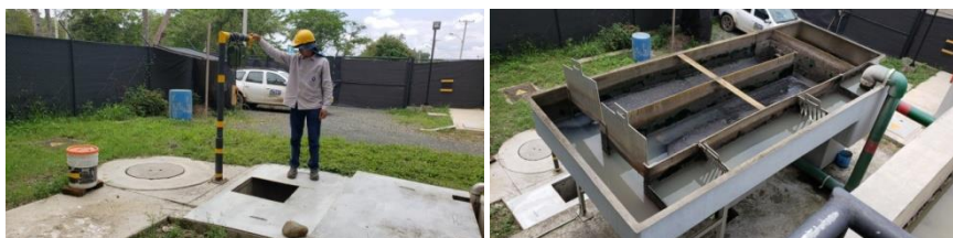
Fotos 1 y 2. Pozo de bombeo y tratamiento preliminar.
