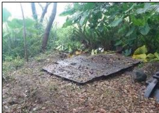
Foto 5. Pozo de Absorción
