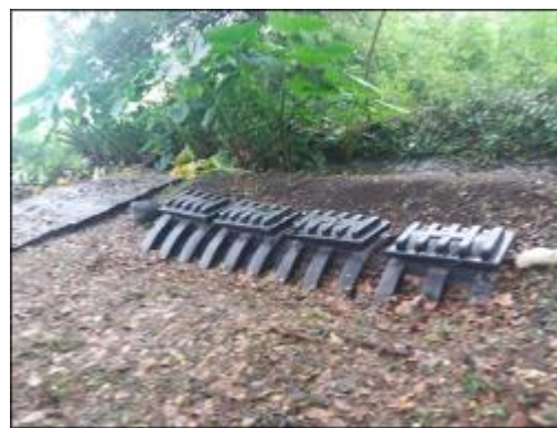
Foto 4. Tanque séptico y Filtro FAFA
