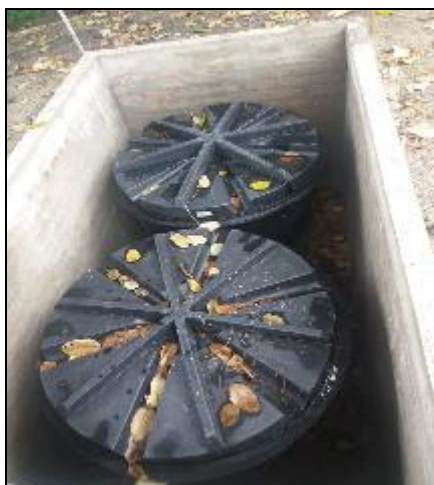
Foto 1. Tanque séptico y Filtro FAFA
