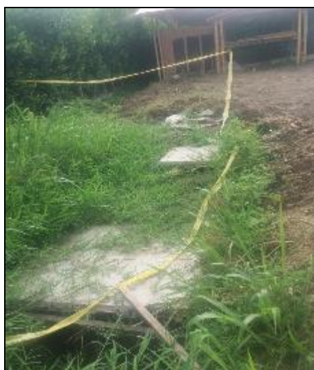
Foto 2. Sistema de tratamiento de tipo convencional – prefabricado
