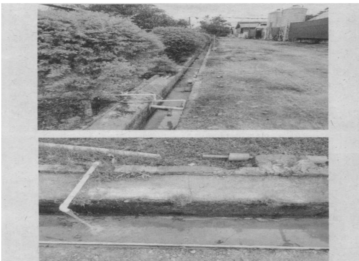
Canal de aguas lluvias donde se realiza la descarga inicial STAR Industrial
