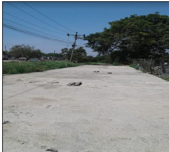
Ilustración 2 Vista superior obras sobre el canal de aguas lluvias, propiedad señora Ruiz Parra
