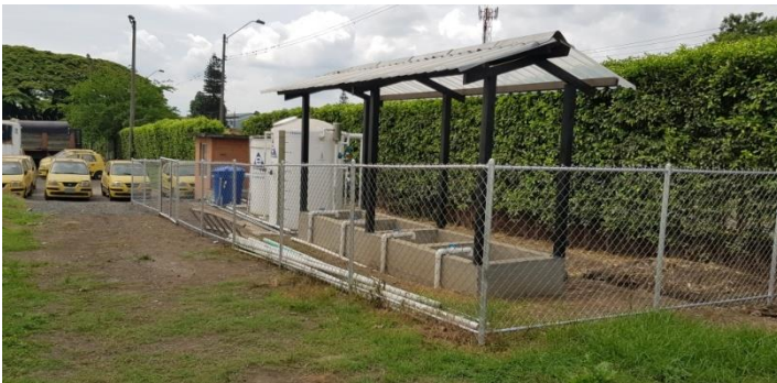
Imagen 1- PTARD con reactor de lodos activados, clarificador, filtros y lecho de secado
