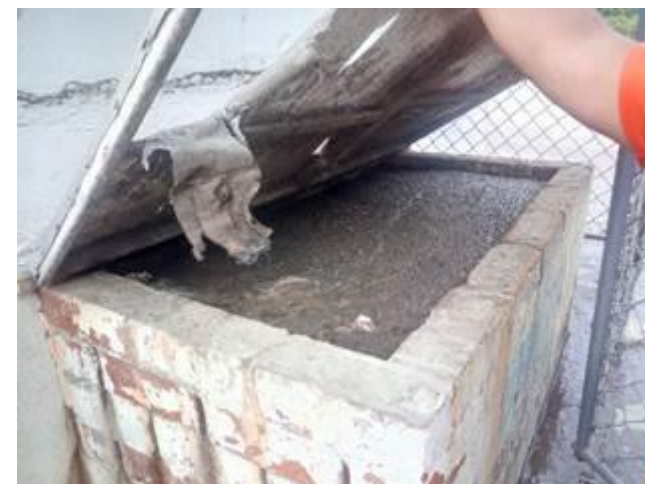
Almacenamiento de lodos.
