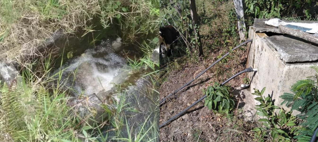
Fotografías Tanques de distribución. A) Tanque 1 y B) Tanque El Amparo
