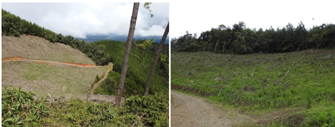
Imágenes 3 y 4. Vista aérea de la vía y detalle de su construcción
