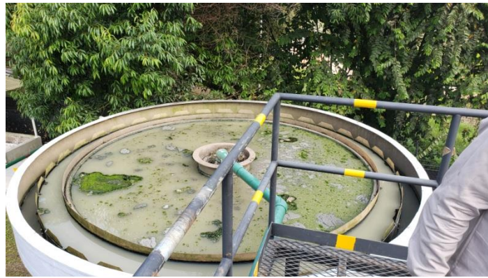
Fotos 1. Mal funcionamiento de sedimentador con lodos flotantes (bulking).
