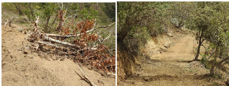
Imágenes 8, 9, 10, 11 y 12. Apertura de vía lote 1 y evidencia de los árboles afectados.
