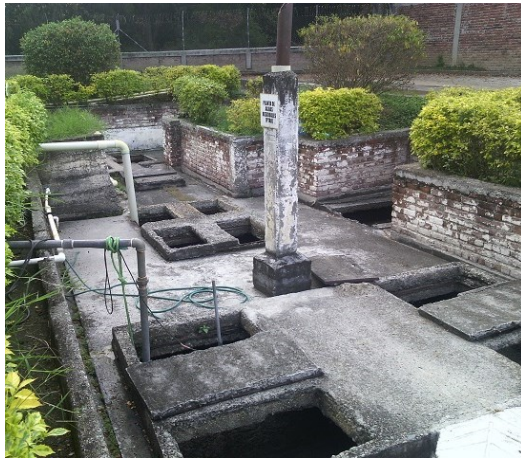
Imagen 5. Tanque sedimentador PTAR Frigotimaná
