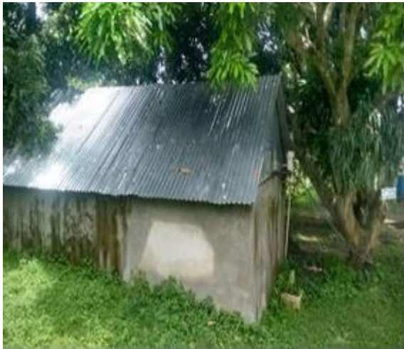
Foto 9. Tanque de almacenamiento aguas Subterráneas.
