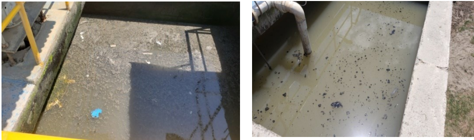
Foto 5 y 6. Aspecto Tanque de Aireación y sedimentador secundario
