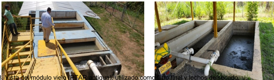
Foto 7 y 8. Vista del módulo viejo (PTAR antigua), utilizado como filtro final y lechos de secado
