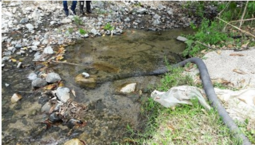
Foto 7: captación ilegal de la quebrada san pedro manguera de 3 pulgadas
