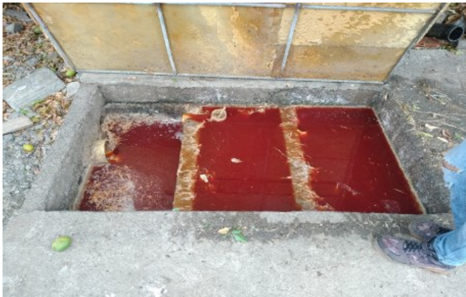
Imagen 6. Trampas de solidos que conducen a tubería para vertimiento final.
