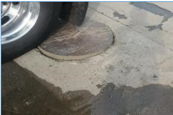
Pozo de agua subterránea / Coordenadas geográficas: 3°55'27.00" N – 76°17'14.40" O
