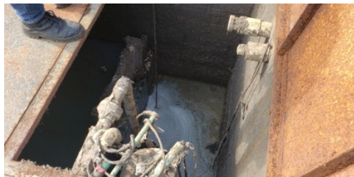
Foto 1. Tanque de igualación y bombeo
