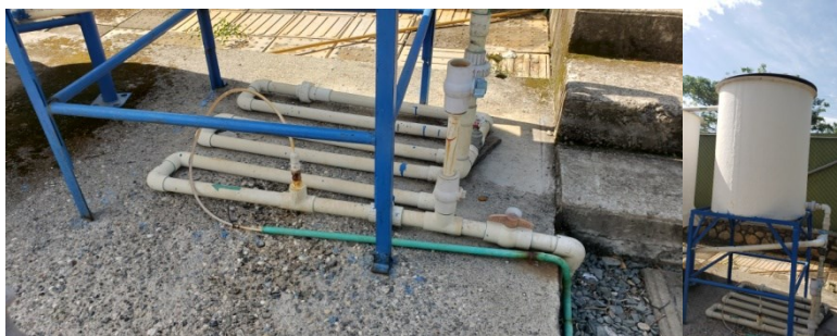
Fotos 2 y 3. Unidades de coagulación - floculación hidráulica
