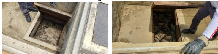
Fotos 2 y 3. Tanque séptico y FAFA.
