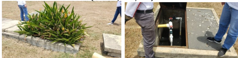
Fotos 4 y 5. Filtro fitopedológico y tanque almacenamiento efluente.
