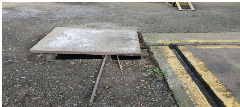
Imagen 3 Trampa de grasas que trata las aguas proveniente de la isla de la EDS
