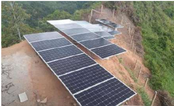
Foto 225. Sistemas fotovoltaicos instalados en el corregimiento de Miravalles, Obando.
