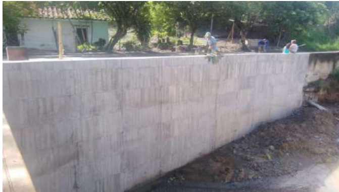
Foto 278. Muro para el control de erosión marginal de la quebrada el Rey en el municipio de Roldanillo.
