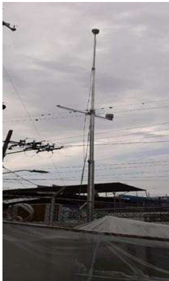
Foto 261 Equipo que hace parte del Sistema de Calidad del Aire ubicada en Yumbo
