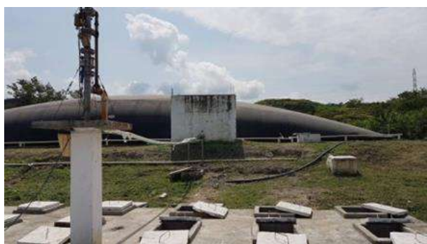
Foto 121 Sistema de tratamiento de aguas residuales empresa Colombina, corregimiento La Paila, municipio de Zarzal – Permiso de Vertimientos Líquidos – DAR BRUT
