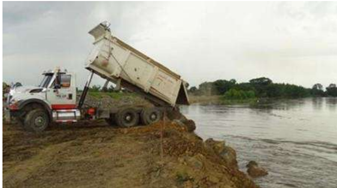
Foto 283. Enrocado de protección sector Caramanta y Ciénaga Redonda Municipio de Bugalagrande.
