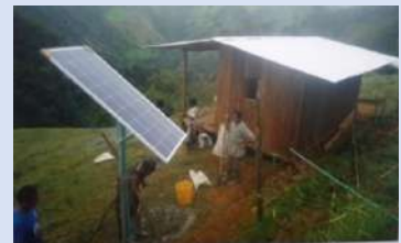
Foto 6. implementación de sistemas fotovoltaicos, Alto Hermoso El Dovio
