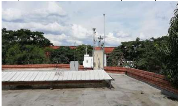
Foto 366 Equipos entregados e instalados
