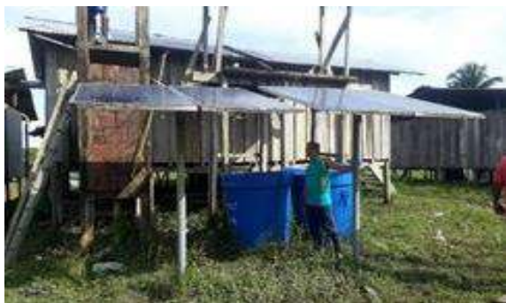
Foto 206. Sistema Fotovoltaico unifamiliar instalado en la comunidad indígena de Puerto Pizarro, Distrito de Buenaventura.
