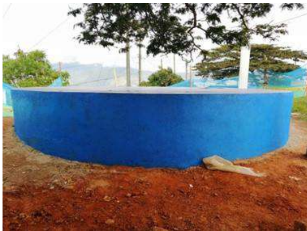
Foto 292. Tanque principal del sistema de reservorios cerro de Cristo Rey.
