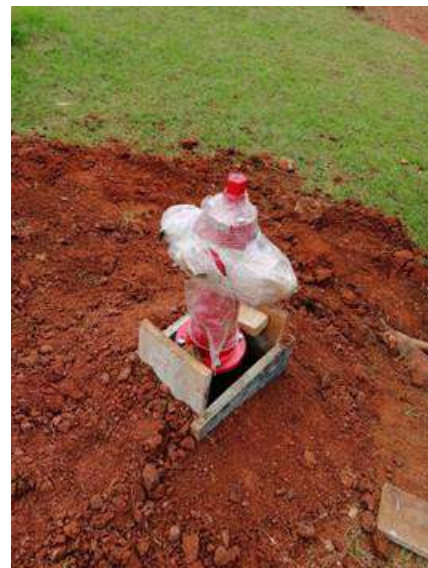
Foto 293. Hidrante tipo Brida para acceder al reservorio principal - cerro de Cristo Rey.
