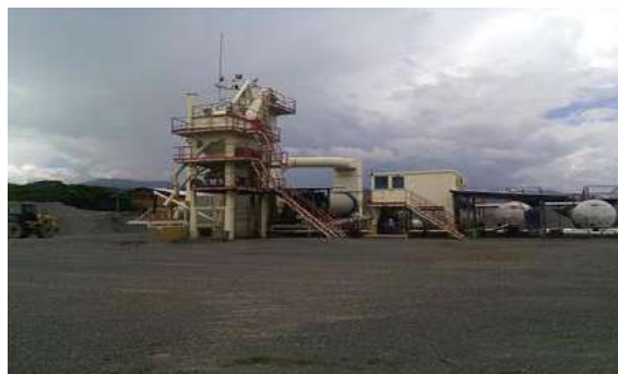
Foto 62. Planta de asfalto INTRAME y Planta de triturado en funcionamiento. PISA – Proyectos de Infraestructura S.A.
