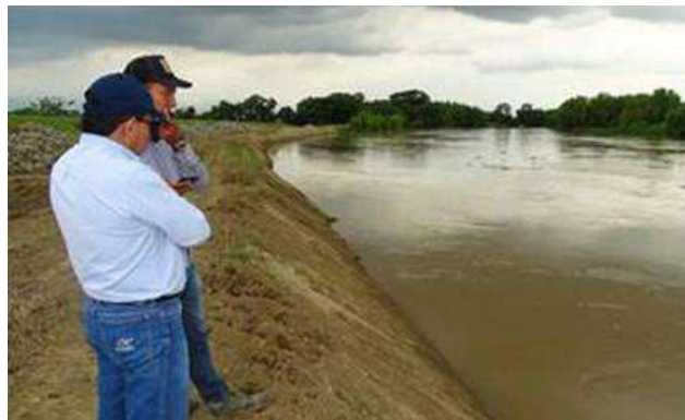
Foto 281. Dique de control de inundaciones construido sobre la margen derecha del río Cauca en el sector San Antonio Municipio de Bugalagrande.
