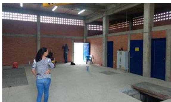
Foto 123. Puesta en marcha estación de bombeo, municipio de Tuluá – DAR Centro Norte.
