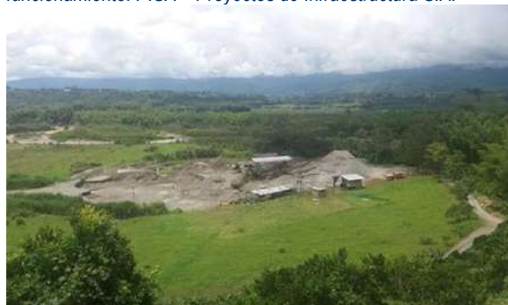
Foto 64. Panorámica de la Planta de Triturado. ARISOL S.A.S.
