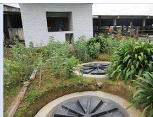
Foto 20. Bateria sanitaria, tanque séptico y filtro anaerobio. Sistema de Tratamiento de Aguas Residuales para la comunidad indígena de Mateguadua en el municipio de Florida.
