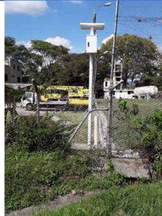
Foto 146. Equipos de soporte, alimentación y transmisión Estación Hidrométrica Derivación 7 río Guadalajara.
