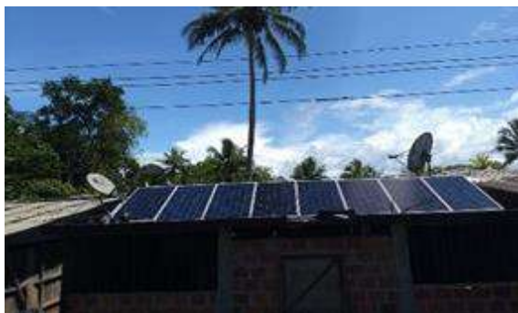
Foto 207. Sistema Fotovoltaico instalado en escuela de una comunidad Del Consejo Comunitario de la Comunidad Negra de Mayorquín, Distrito de Buenaventura., Distrito de Buenaventura.
