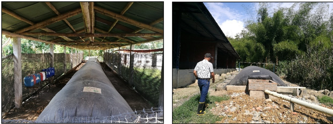
Figura 1. Biodigestores instalados en el predio La Fabiola
