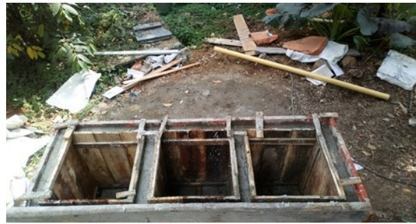
Foto 1B. Trampa de grasas nueva
