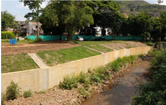
Foto 88 Muro de protección de orilla en concreto reforzado, Polideportivo Belisario Caicedo. Comuna 20
