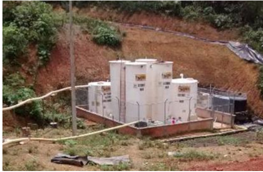
Foto 41. Planta de Tratamiento de Lixiviados – sitio de disposición final de residuos sólidos, municipio de Buenaventura –DAR Pacífico Oeste.
