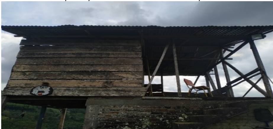
Imagen No. 3. Observancia de deterioro de madera actual en estructura construida con anterioridad.
