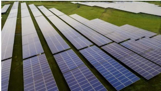
Figura 1 Paneles solares en la planta solar Fotovoltaica de Yumbo
