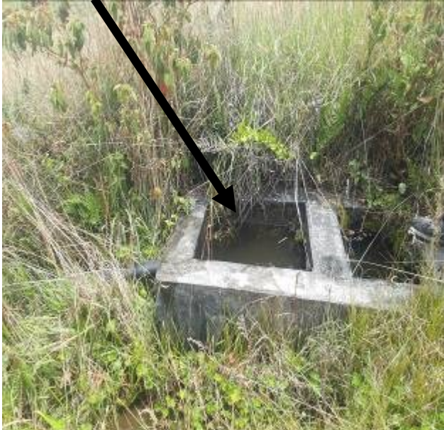
Bocatoma para captación. Quebrada Bombay. Predio El Sinú.
