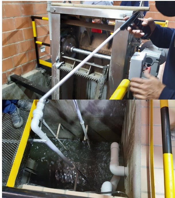
Fotografías 3 y 4. Vista de la Rejilla Autolimpiante y del Tanque de Igualación y Bombeo.
