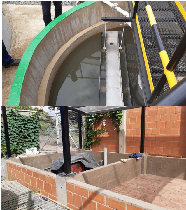
Fotografías 11 y 12. Vista del efluente de los clarificadores y de los lechos de secado de lodos.
