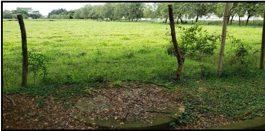
Foto 2. Aspecto cámara de conexión EBAR a alcantarillado Acuavalle S.A. ESP.
