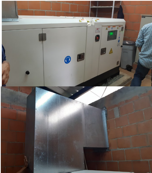
Fotografías 5 y 6. Vista parcial de planta eléctrica, equipos de control y ducto de salida.
