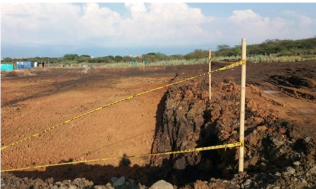
Fotografía 4: Explanación vista sur, fecha 17 de Marzo 2020.
