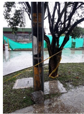
Foto # 3 Afecta dos cajas del sistema eléctrico interno
