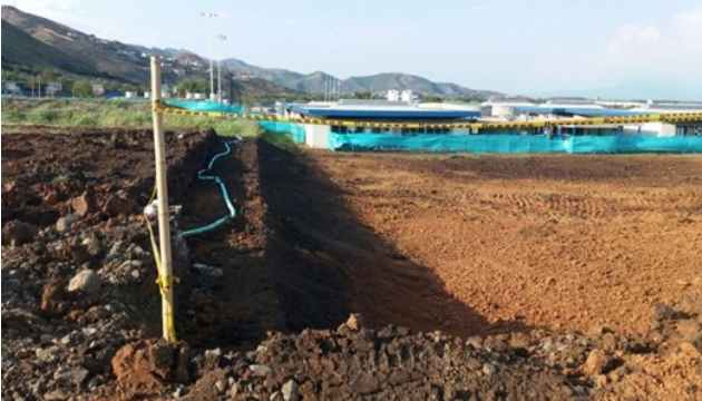
Fotografía 2: Explanación vista sur, fecha 17 de Marzo 2020. Sitio de adecuación de terreno, fuente propia
