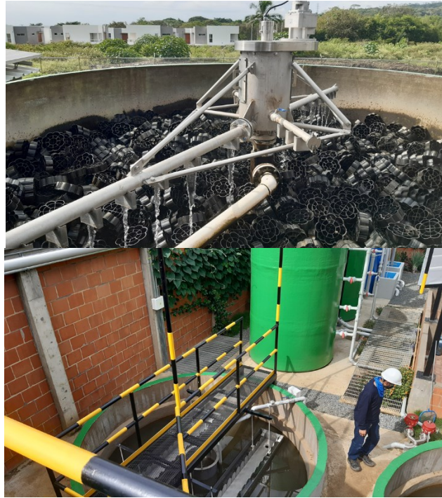
Fotografías 9 y 10. Vistas del interior del filtro percolador y del clarificador.
