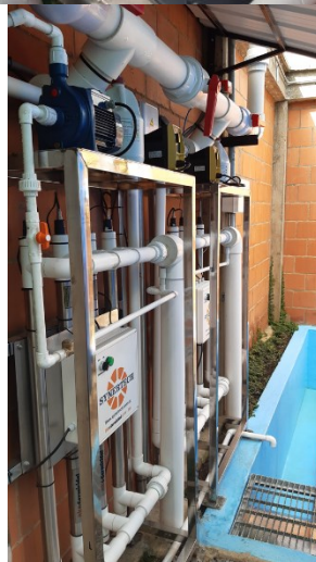
Fotografías 15 y 16. Vista de los equipos de cloración y de desinfección con luz ultravioleta.
