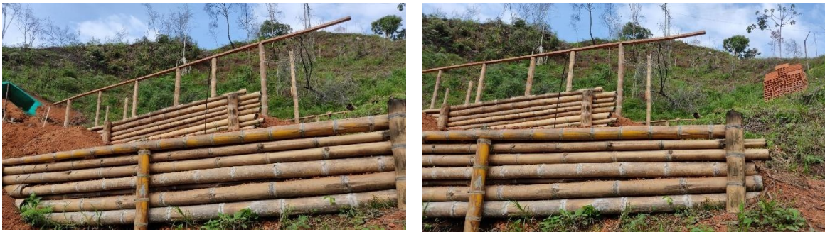
Imagen 3: Se observó la instalación de trinchos de guadua y presencia de ladrillo en el sitio de la explanación.
