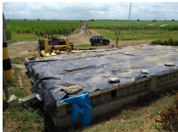
Foto 8. Casa de Máquinas, donde se encuentran los Equipos
