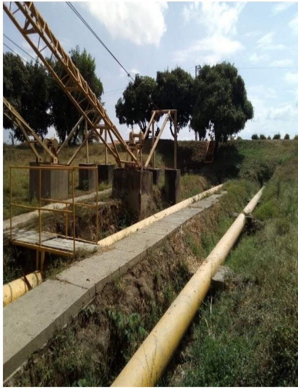
Foto 2. Tuberías de succión hacia las Bombas
