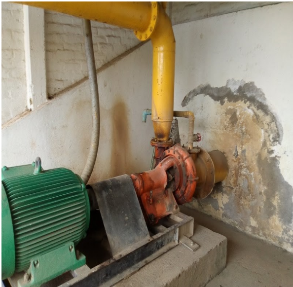
Foto 3. Sistema 1 – Bomba - Motor y Descarga
