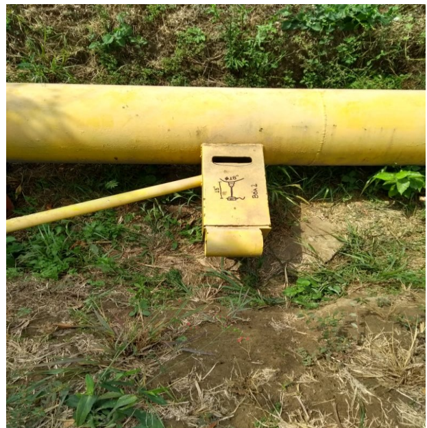
Foto 9. Sensor para el Bombeo No. 2
