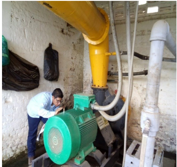
Foto 4. Sistema 2 – Bomba - Motor y Descarga
