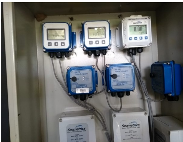
Foto 7. Panel de Control – para Registro de caudal Captado
