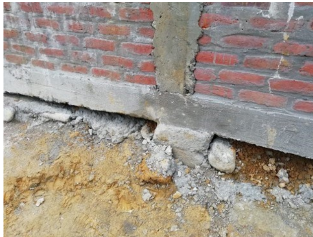
Foto 6. Detalle del estado de la construcción, entre el suelo y la losa del piso y la columna de soporte.
