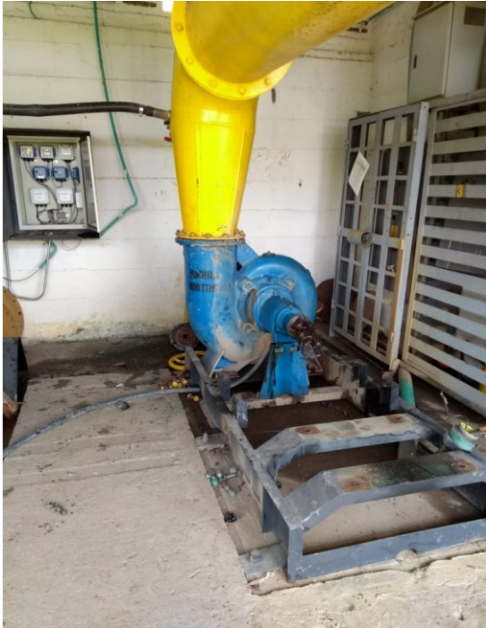
Foto 5. Sistema 3 – Bomba y Descarga
