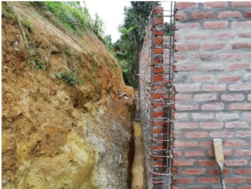
Foto 5. Se observa la escasa distancia entre muro de estructura y talud de corte, generando un alto riesgo de que, ante una falla del talud, se tape parcialmente o totalmente la vivienda.
