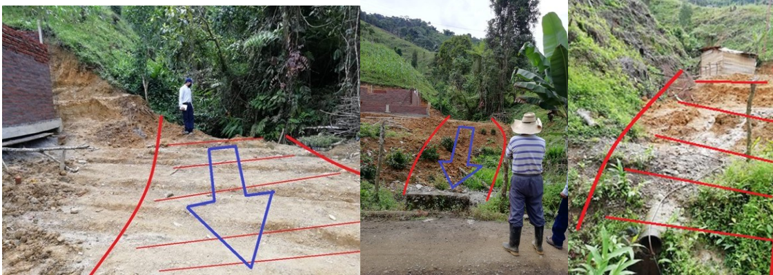
Fotos 8, 9 y 10. Las fotos 8 y 9 muestran el drenaje de aguas permanentes y en la foto 10 el drenaje de aguas intermitentes, drenajes que deben ser recuperados en su capacidad hidráulica.
