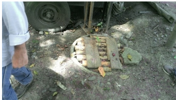
Foto No.2 Vista superior de pozo tapado.
