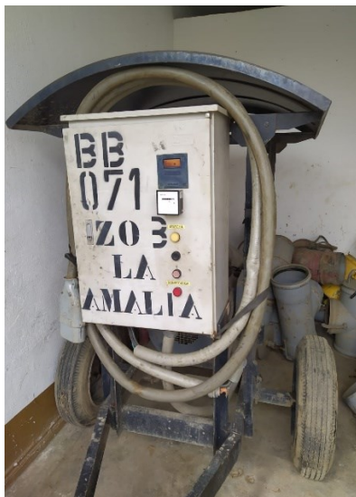
Foto 4. Motor electrico empleado para el Bombeo
