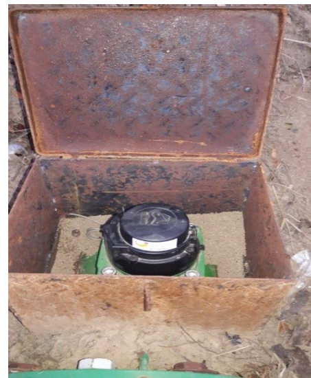
Foto 5. Medidor de Flujo
