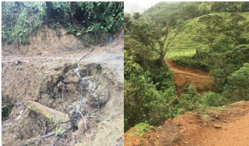
Foto No 5,6 topografía que presenta el terreno sobre el área intervenida y afectación e otras corrientes de agua.
