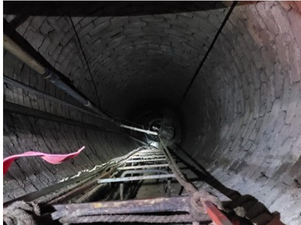
Foto No. 1 Vista superior del pozo
